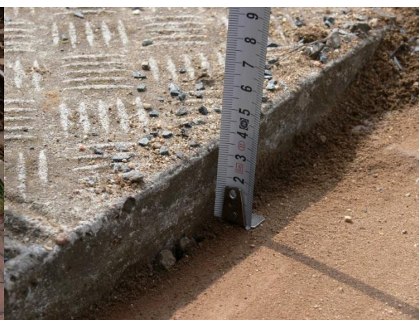
Obrázek 27 Výškový „schod“ na rozhraní rampy a povrchu nástupiště č. 1
