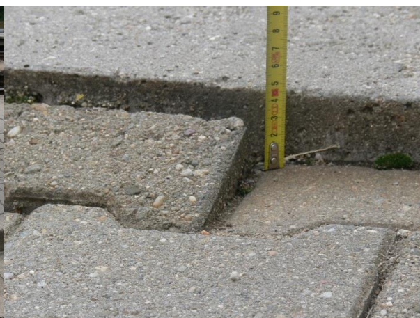
Obrázek 49 Výškový rozdíl mezi rampou a přechodem
