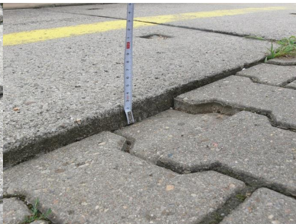
Obrázek 53 Lokální poruchy na druhé části nástupiště č. 1
