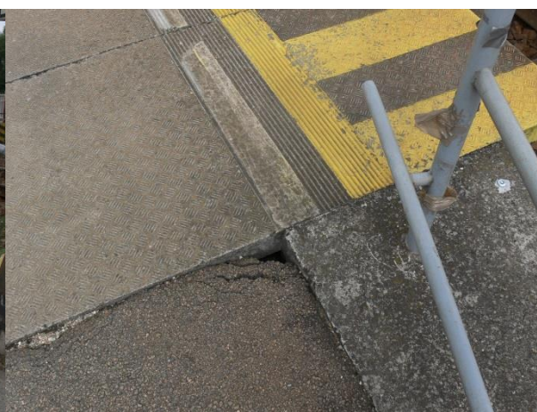
Obrázek 62 Diskontinuity na přístupové komunikaci
