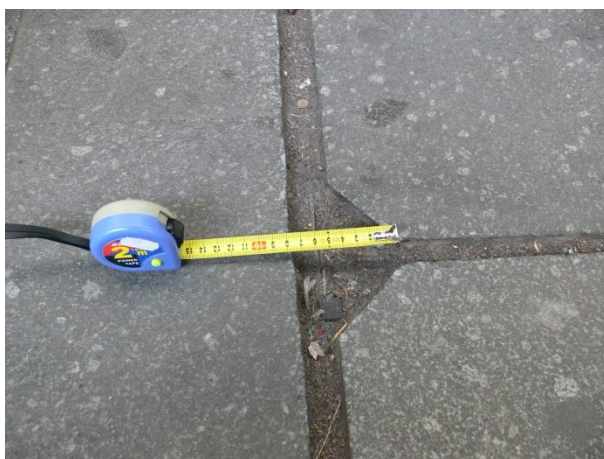
Obrázek 114 Poškození povrchu nástupiště č. 1
