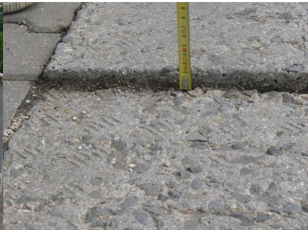
Obrázek 68 Deformace povrchu nástupiště
