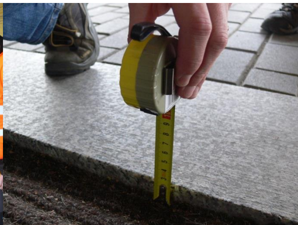
Obrázek 88 Výškový rozdíl mezi podlahou výpravní budovy a podestou rampy
