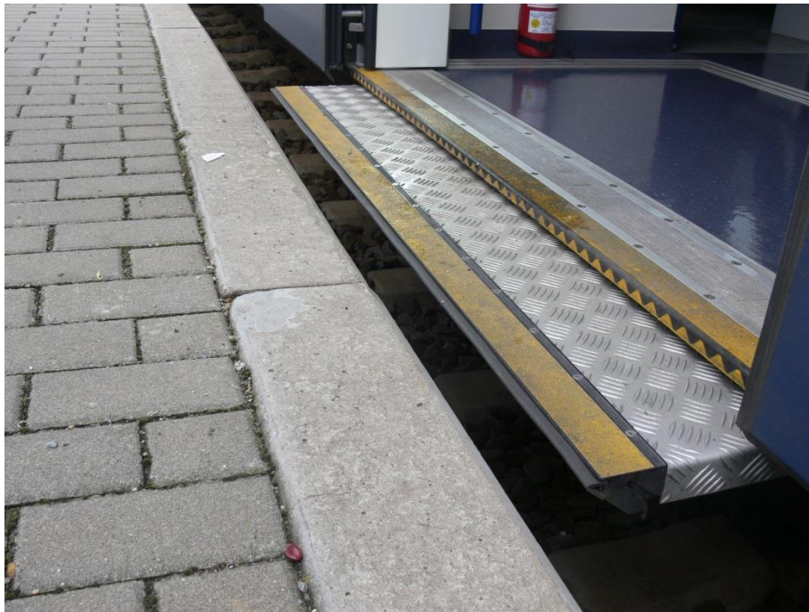
Obrázek 84 Mezera mezi nástupní hranou nástupiště č. 2 a podlahou vozidla u koleje č. 1
