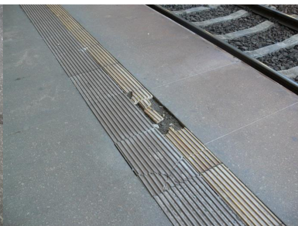
Obrázek 115 Poškození povrchu nástupiště č. 1
