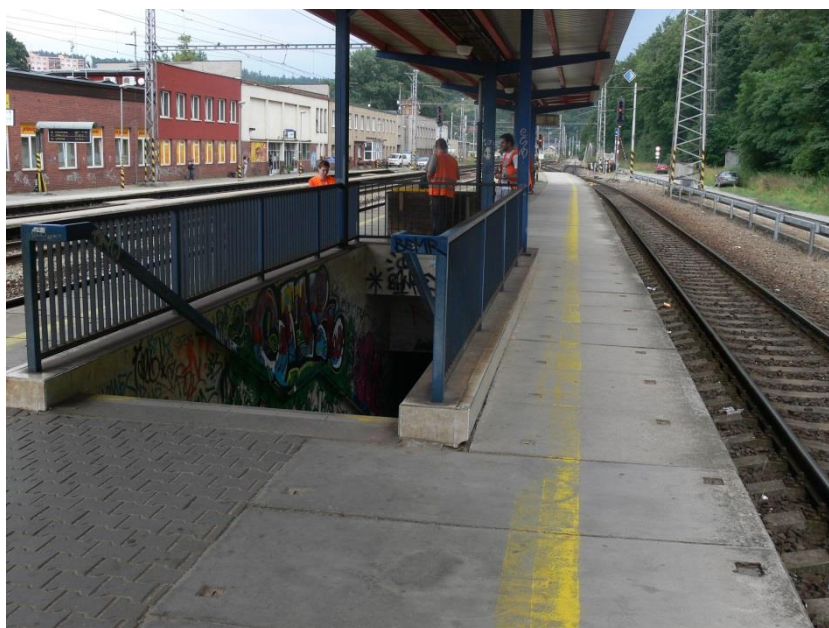
Obrázek 56 Překážky na nástupišti č. 3
