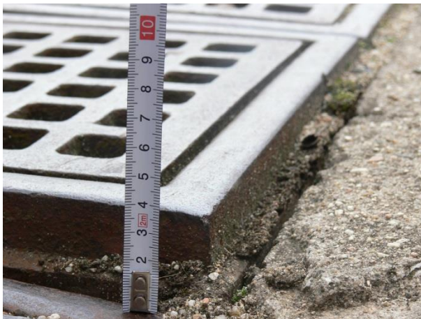
Obrázek 45 Vertikální nerovnosti v místě krytu odvodňovacího zařízení
