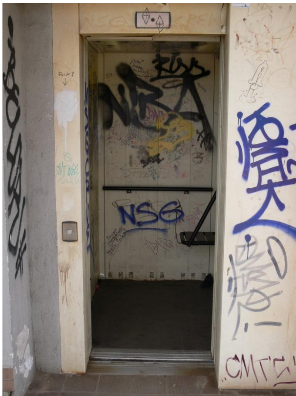
Obrázek 31 Výtah vedoucí z podchodu na nástupiště č. 3
