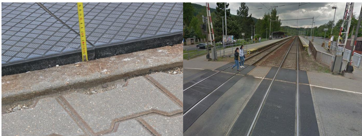
Obrázek 64 Deformace povrchu železničního přejezdu
