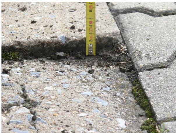
Obrázek 52 Lokální poruchy na druhé části nástupiště č. 1
