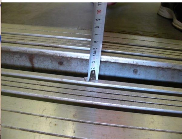
Obrázek 32 Přesnost zastavování výtahové klece
