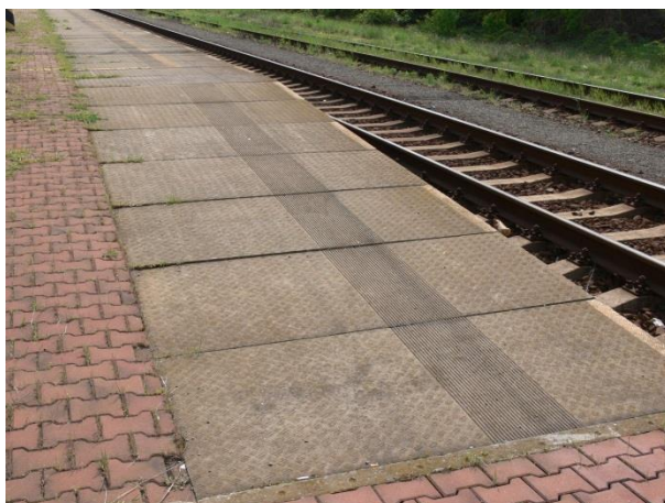
Obrázek 37 Výškové rozdíly sousedních desek na ploše rampy
