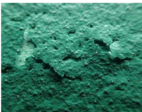
Obrázek 38: Poškození nátěrového systému vzorku Z3PV-CH25
