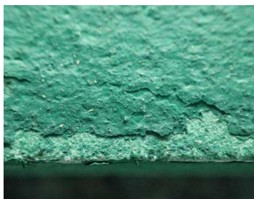
Obrázek 39: Poškození hrany nátěrového systému vzorku Z3PV-CH25
