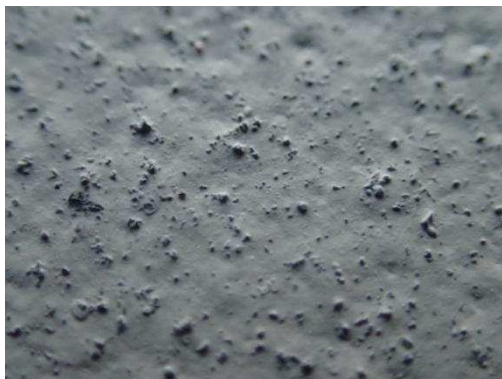
Obrázek 33: Poškození nátěrového systému vzorku S3PV-M50
