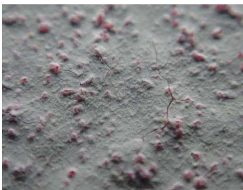
Obrázek 44: Poškození nátěrového systému vzorku S3PE-CH25
