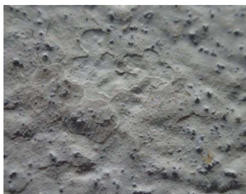
Obrázek 43: Poškození hrany nátěrového systému vzorku S3PV-CH25
