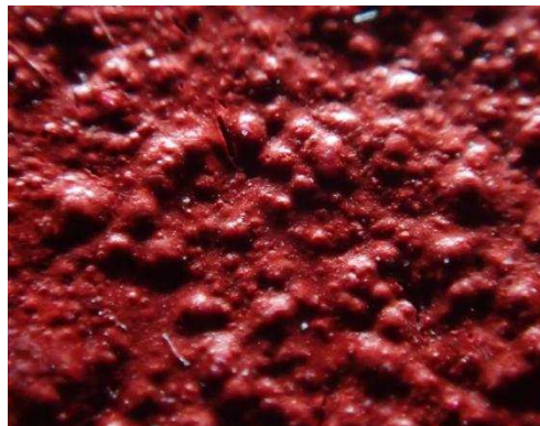
Obrázek 55: Detail lícové strany nátěrového systému 2C-REF
