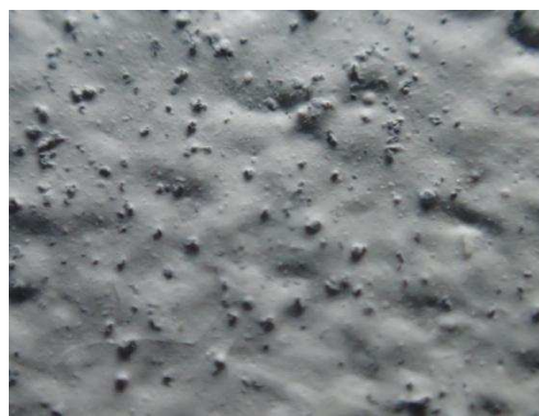
Obrázek 34: Poškození hrany nátěrového systému vzorku S3PV-M50
