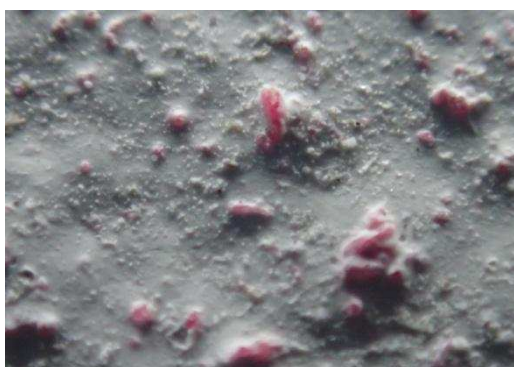
Obrázek 35: Poškození nátěrového systému vzorku S3PE-M50
