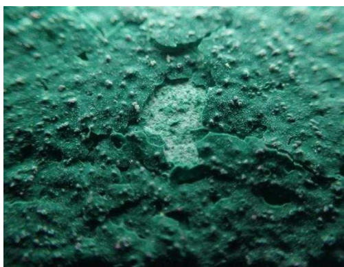
Obrázek 40: Poškození nátěrového systému vzorku Z3PE-CH25
