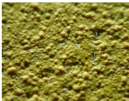
Obrázek 63: Detail lícové strany nátěrového systému 1Z-S po působení M125 a Q20
