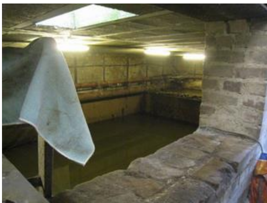
Obr. č. 21 - Podzemní nádrž na 300 m 3 dešťové vody pro toalety a zalévání. UFA Fabrik, Berlin, DE (zdroj: Nehasil, 2012)
