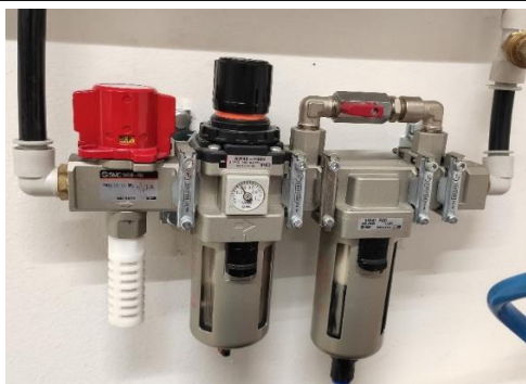
Obr. 76) Jednotka úpravy stlačeného vzduchu ve zkušebně
