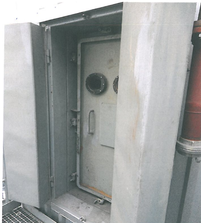
Obr.10. Dveře do věže s filtry. Dveře jsou uzamčeny pomocí 6 šroubů na určitý moment. Do budoucna uvažuje EOP o zámku podobně používaném na ponorkových dveřích či na dveřích přepážek v lodích a to z důvodu zrychlení možnosti otevření a uzavření.
