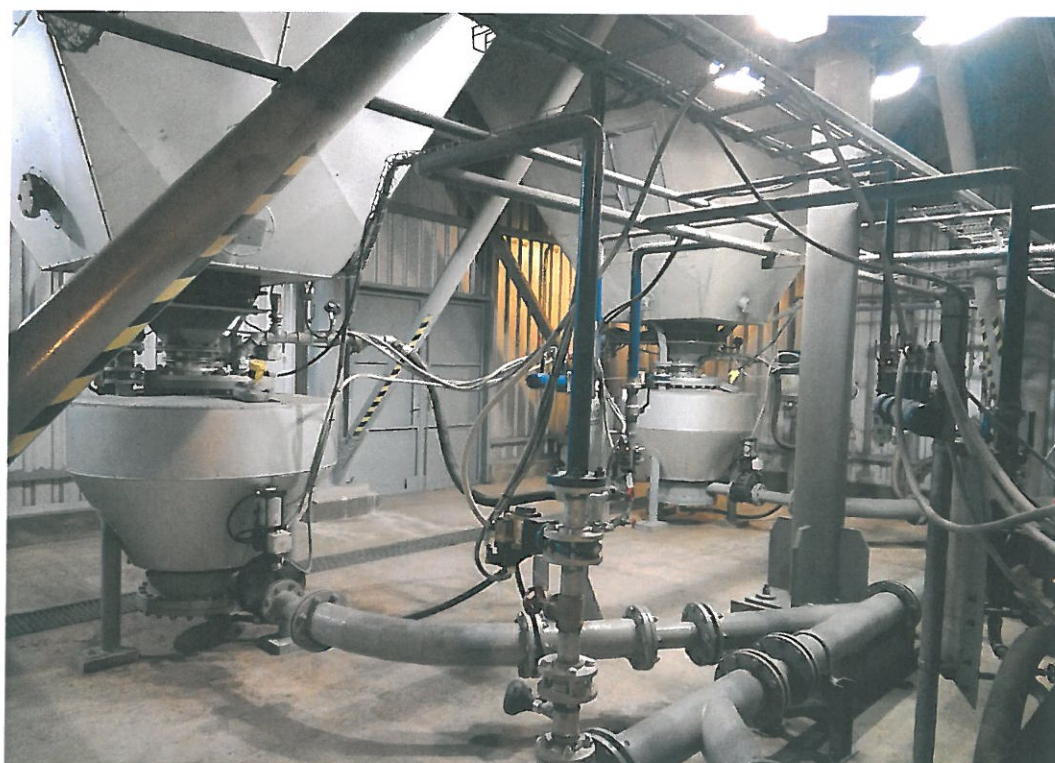
Obr.11. Pohled do spodní části věže pod filtry. Jak je zde vidět v každé věži jsou 4 jednotky které po naplnění automaticky odvádí prachové částice ze zásobníků.
