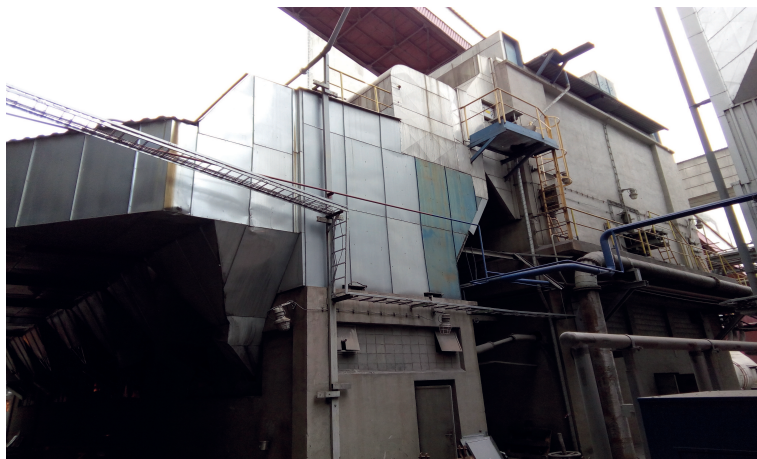
Obr. 6. Technologie odprašování spalin před rekonstrukcí
