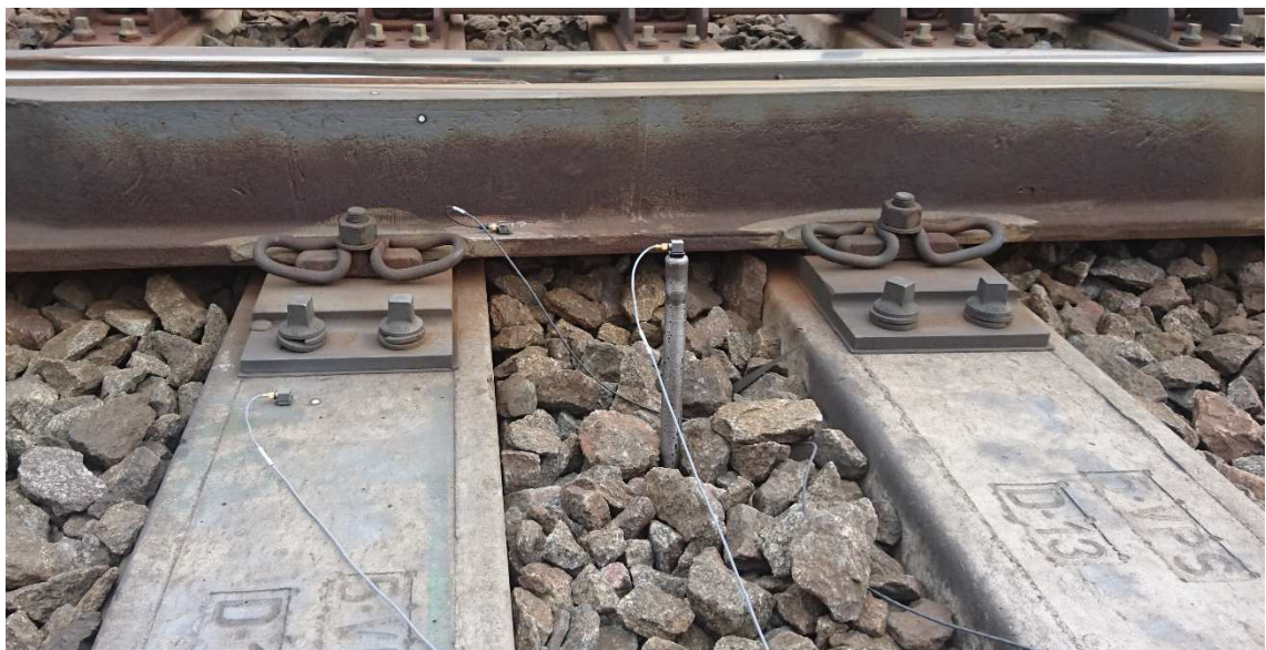
6 Rozmístění snímačů na srdcovce ve výhybce č. 3
