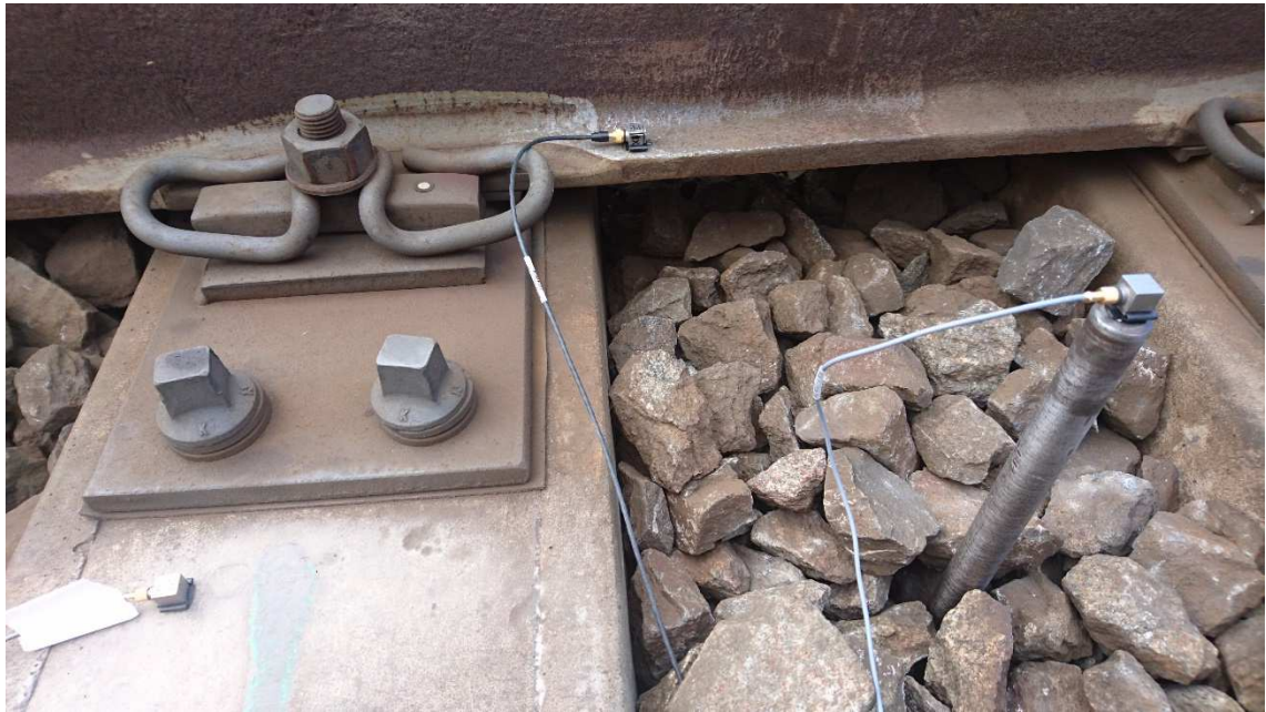
5 Rozmístění snímačů na srdcovce ve výhybce č. 4
