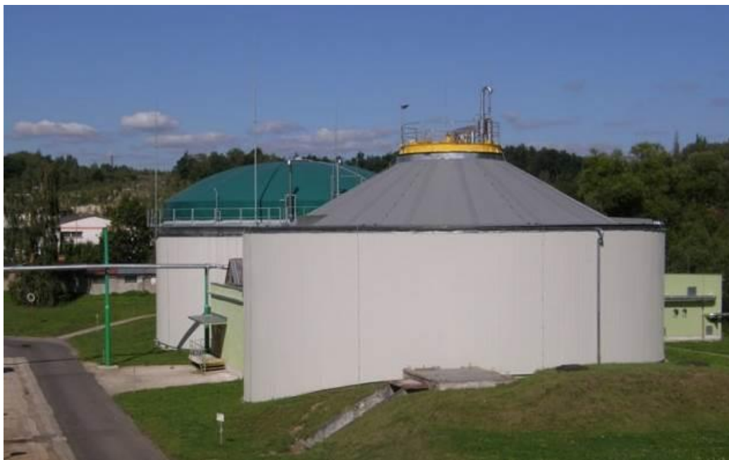
Obr. č.3 - Vyhnívací nádrže na ČOV Karlovy Vary [zdroj: vlastní].
