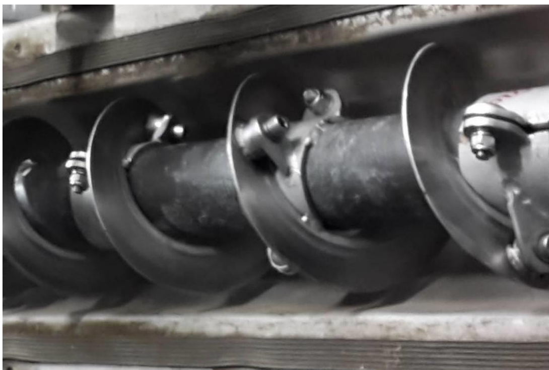
Obr. č. 14 – Nový dopravník vysušeného kalu [zdroj: vlastní].
