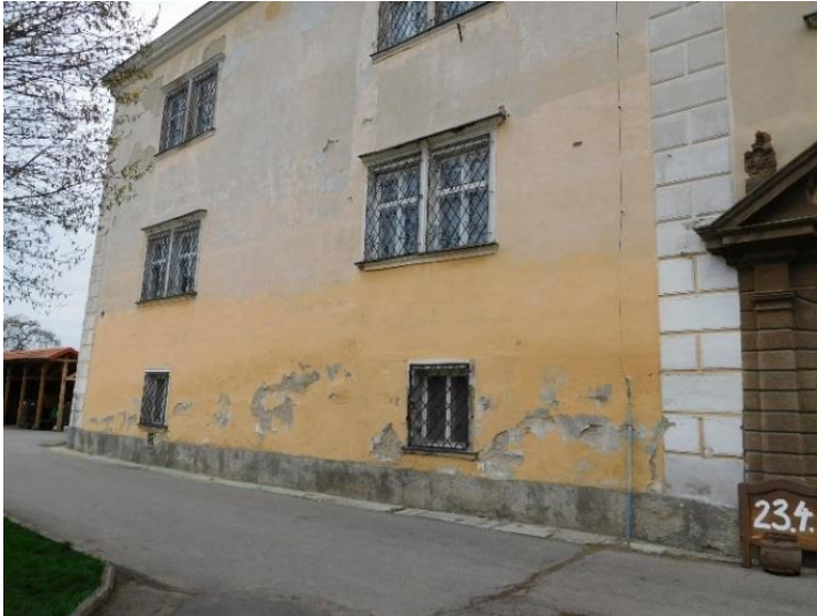
Obrázek 7 Špatný stav fasády v přední části zámku Zdroj: vlastní zpracování, foceno 8.4.2016
