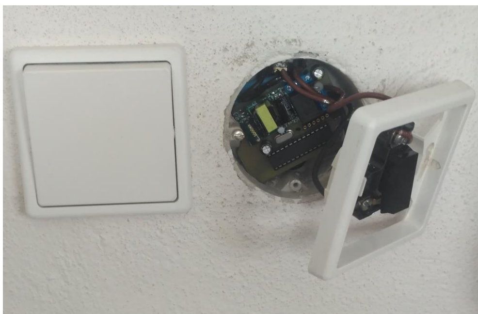
Obr. 3.14: Fotografie nainstalovaného modulu osvětlení pod vypínačem.
