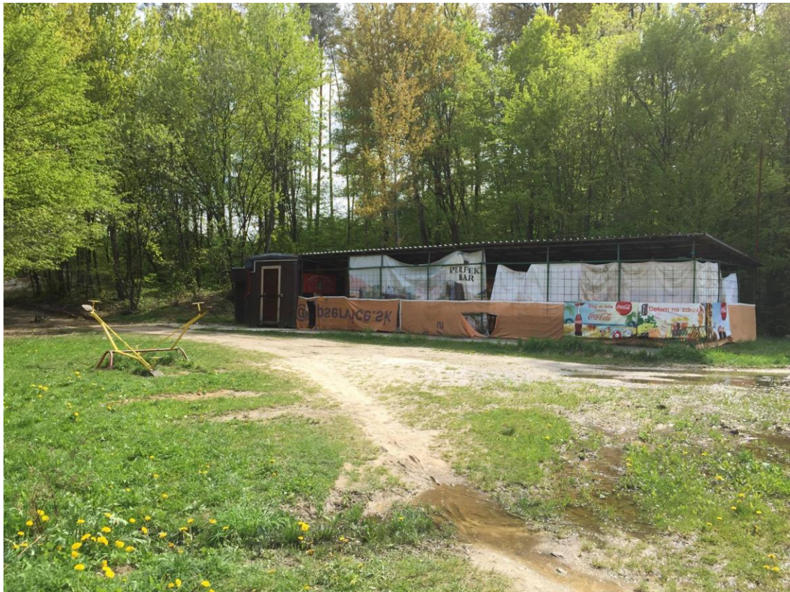
Obrázok 22 - Chátrajúci objekt v tesnej blízkosti vodnej nádrže
