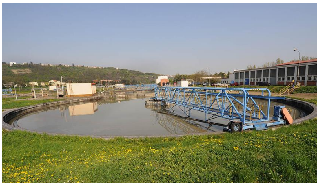
Obrázek 15: ÚČOV usazovací nádrže (Pvk, 2023)
