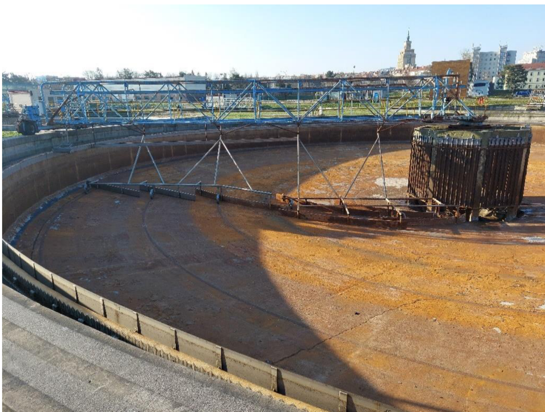
Obrázek 16: ÚČOV vypuštěná usazovací nádrž –otočné rameno se stíracím hřablem
