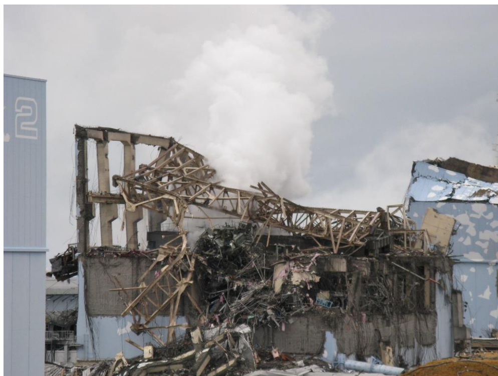
Obrázek 8: Třetí blok JE Fukušima po výbuchu vodíku (TEPCO, 2013)
