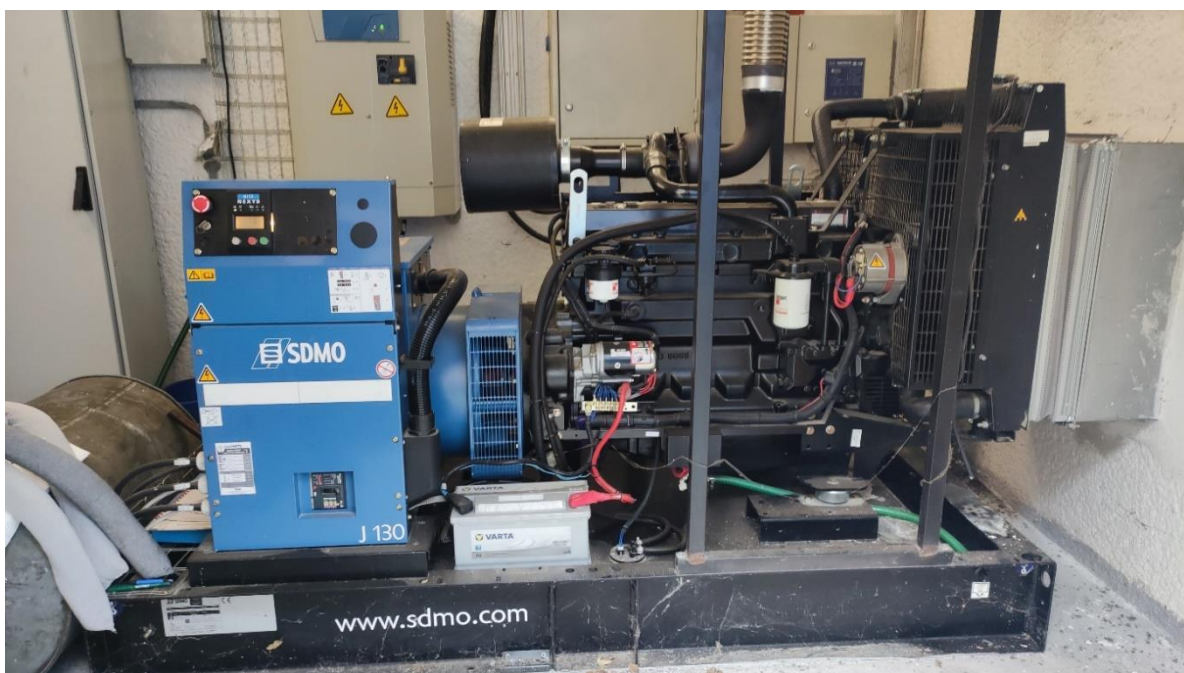
Obrázek 6 Diesel agregát v budově tavírny
