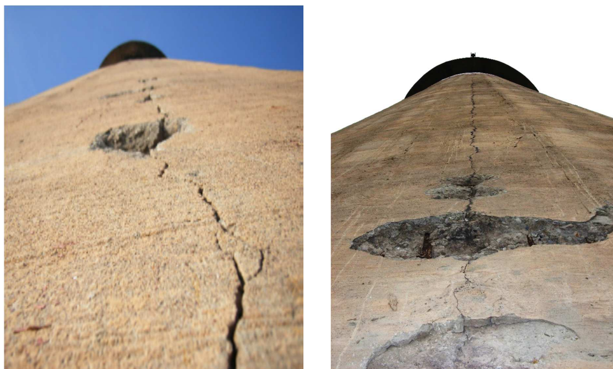
Obr. 7 – Fotografie podélné trhliny betonového dříku
