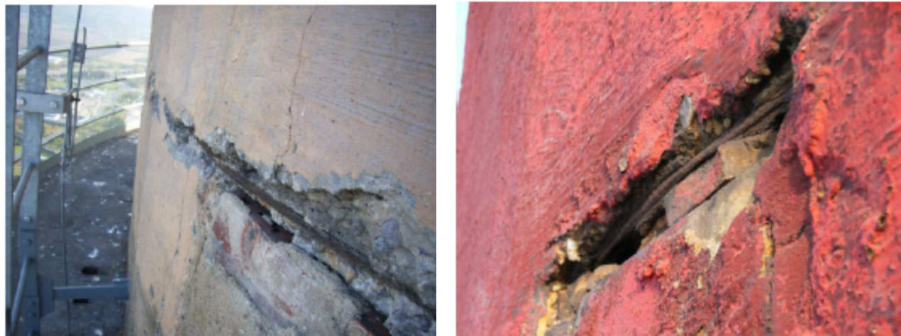
Obr. 6 – Fotografie příčného rozrušení betonového dříku
