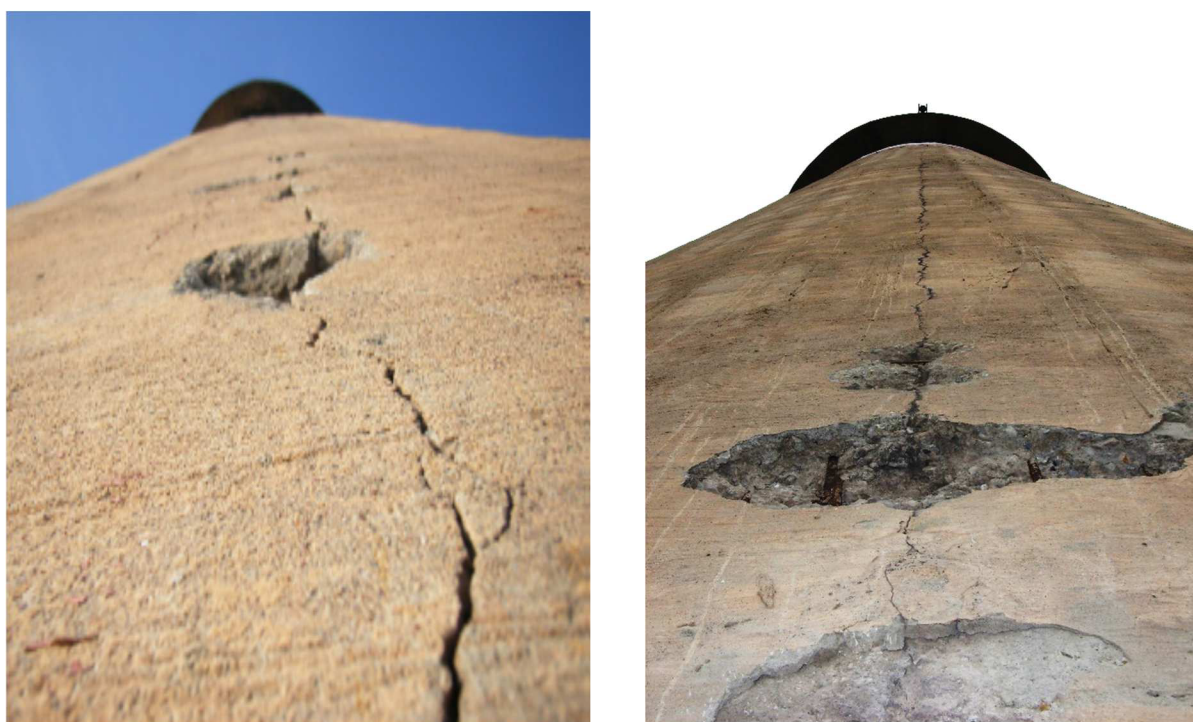
Obr. 7 – Fotografie podélné trhliny betonového dříku
