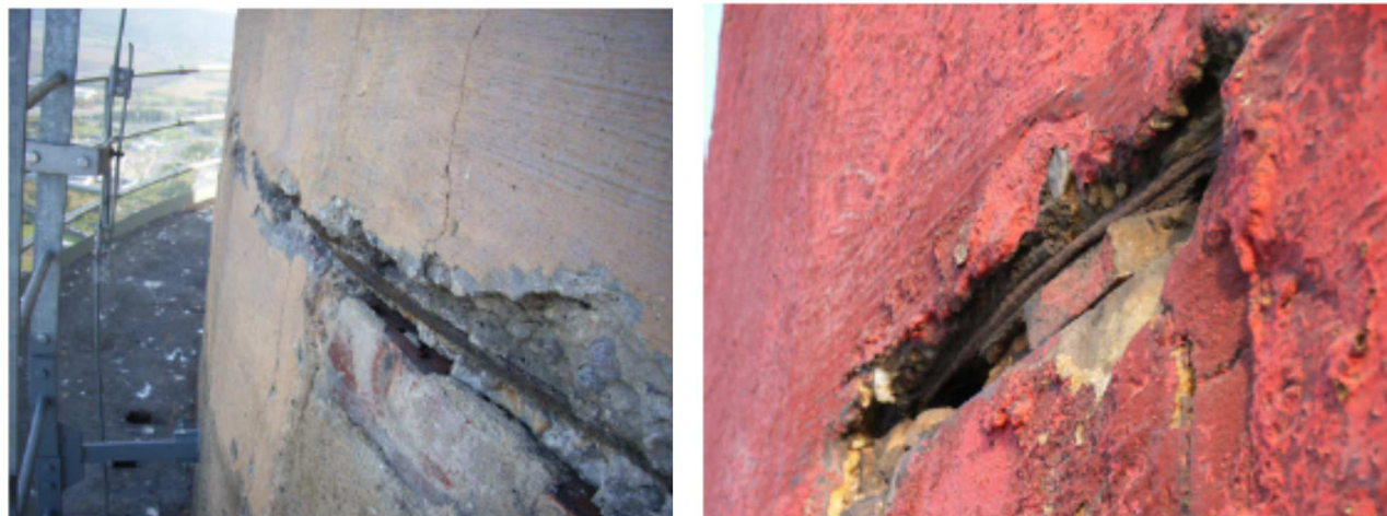
Obr. 6 – Fotografie příčného rozrušení betonového dříku
