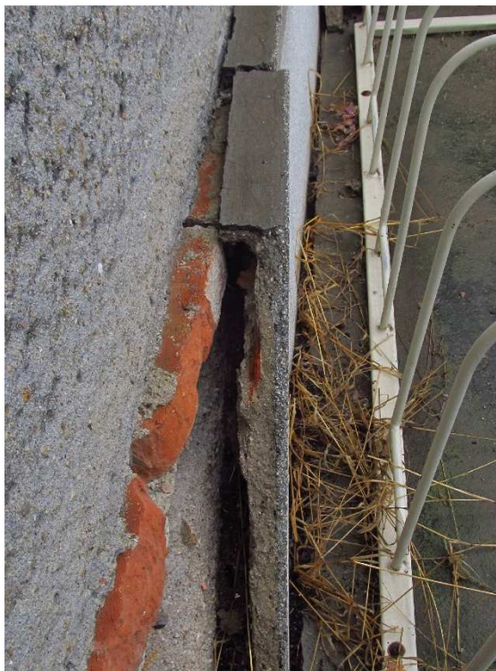
Obrázek 26: Odpadávání soklových přizdívek [vlastní]
