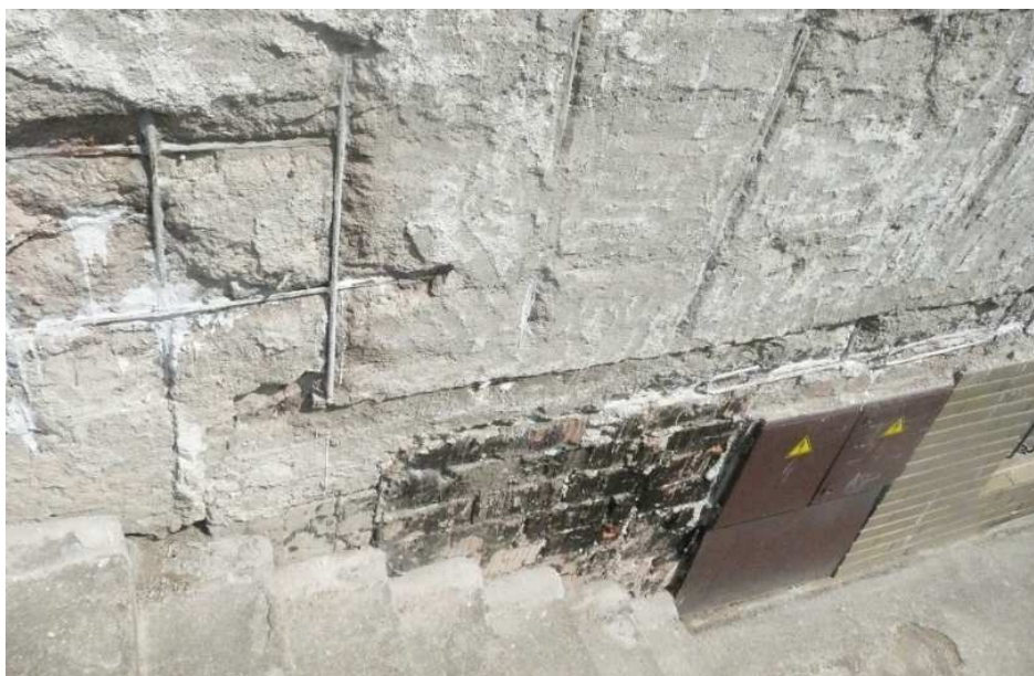
Obrázek 27: Obnažená výztuž stěny [vlastní]
