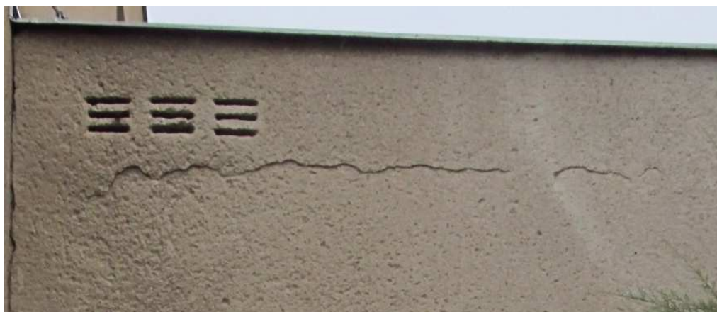
Obrázek 25: Trhliny u atikového panelu [vlastní]
