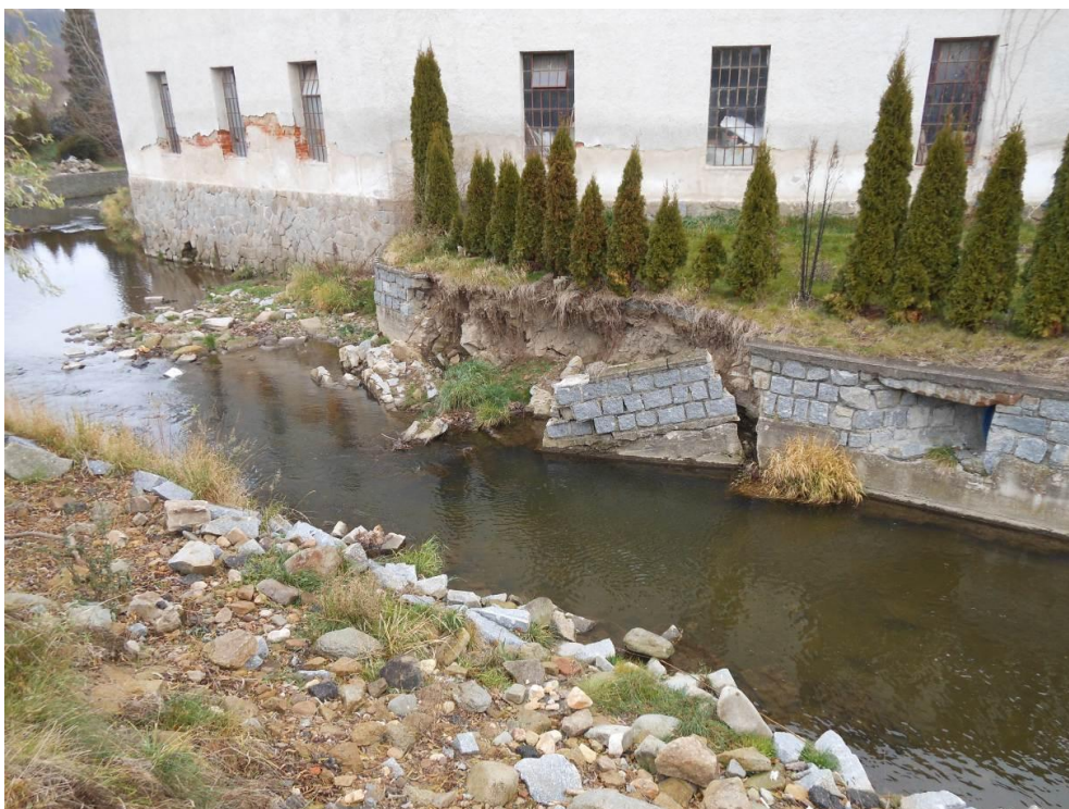
Obr. č. 6: Poničené koryto Mastníku v Kosově Hoře za silničním mostem
