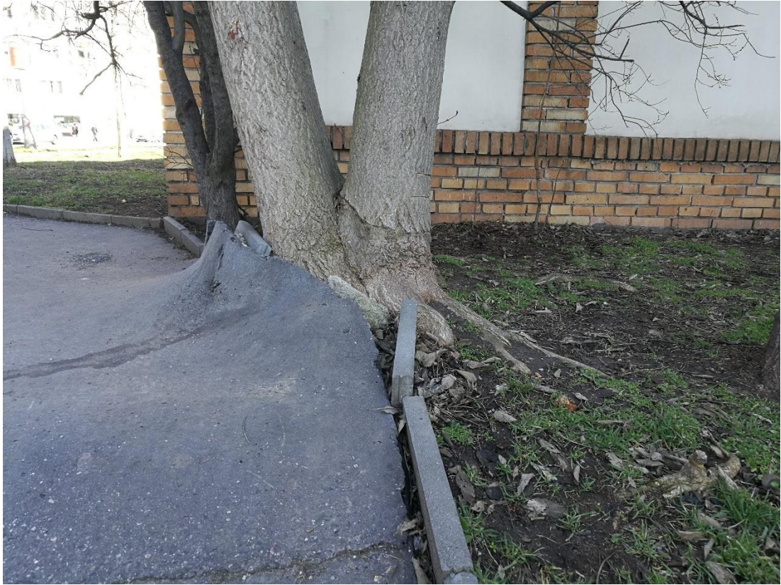
Obrázek 15 – Poničený chodník na rohu Pražské tržnice v ulici Jateční (autor 2021).
