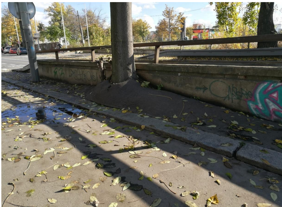
Obrázek 13 – Poničená komunikace v ulici U Papírny (autor 2020).
