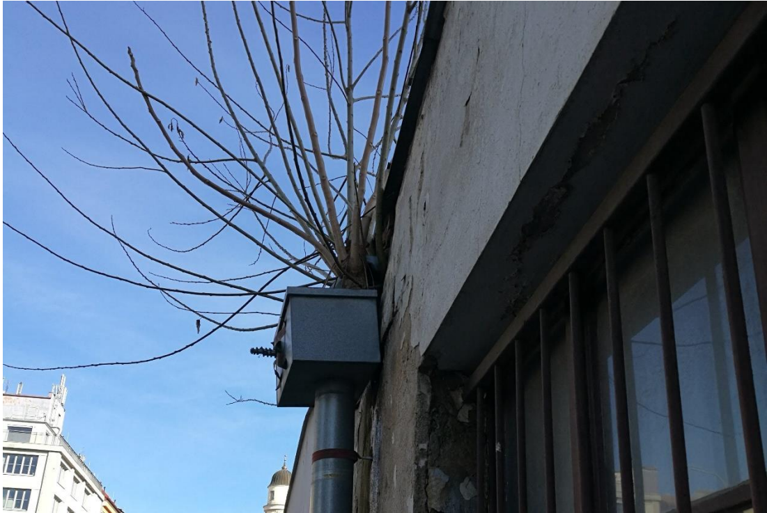
Obrázek 11 – Pajasan vyrůstající ze zdi na střeše budovy v Tusarově ulici (autor 2021).
