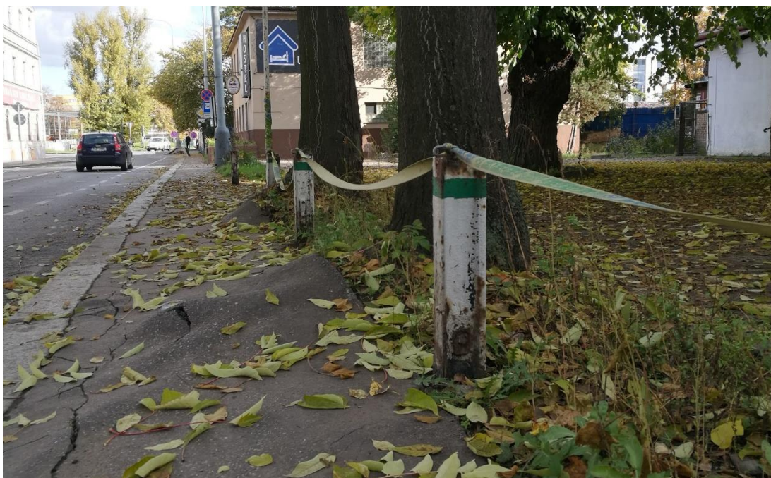
Obrázek 14 – Poničený chodník v ulici Železničářů (autor 2020).
