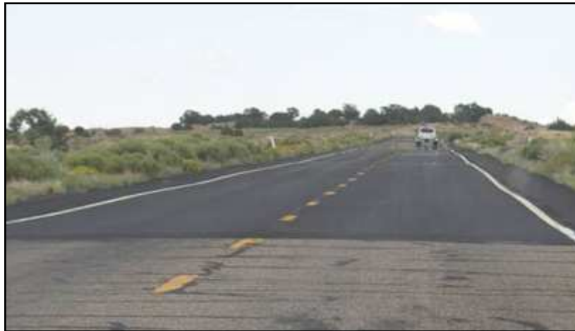
Obrázek 5: Úsek s běžnou obrusnou vrstvou z asfaltového betonu porušenou trhlinami (v popředí) a s gumoasfaltovou obrusnou vrstvou (v pozadí)
