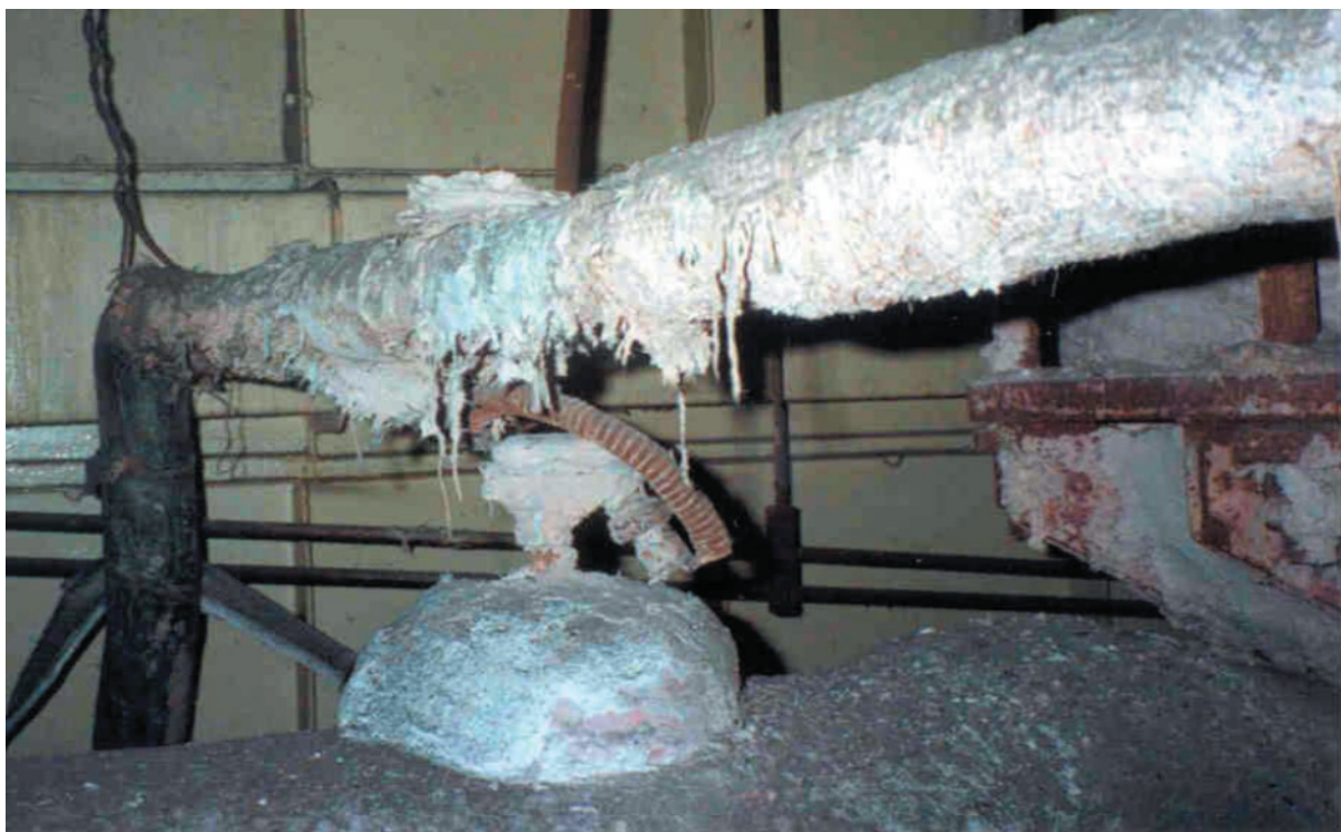
Obrázek 4: Azbestová izolace na parovodním potrubí (Zdroj: Evropská komise GŘ pro zaměstnanost, sociální věci a rovné příležitosti 2006)
