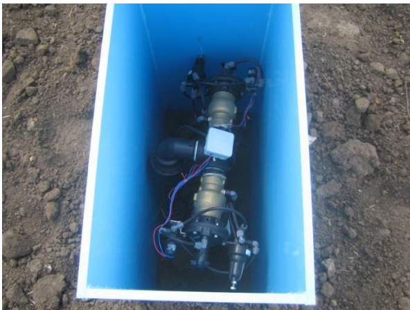
Obrázek 8 Dva hydraulické ventily uložené v ochranné šachtě (zdroj: Vlastní archiv)
