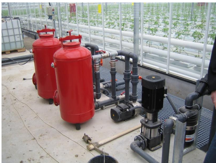
Obrázek 4 Písková filtrace - další typ hojně používaného filtru (zdroj: Vlastní archiv)
