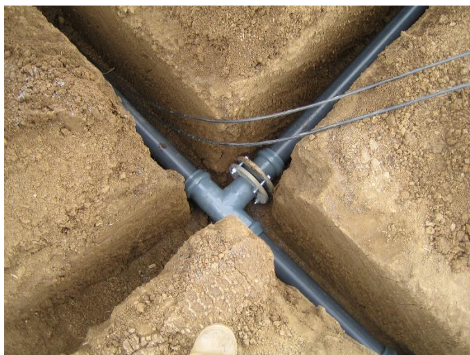
Obrázek 6 PVC roury použité jako páteřní rozvody pro vinici (zdroj: Vlastní archiv)
