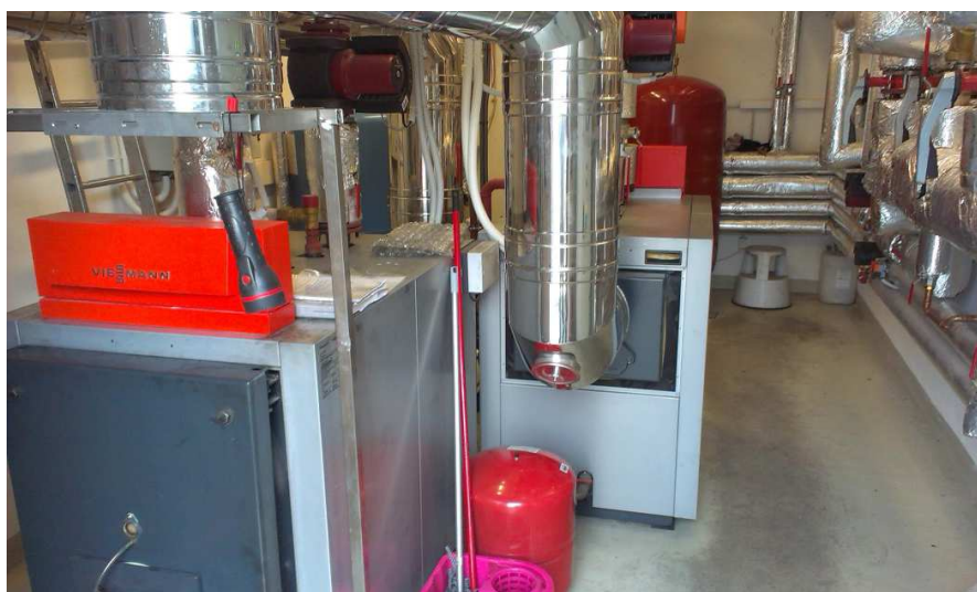
Obr.: Kotelna na řepkový olej v obchodním domě Tesco v Jaroměř, foceno při exkurzi, jaro 2014
