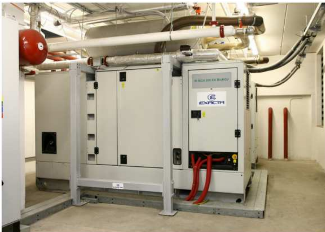
Obr.: Kogenerační jednotka na řepkový olej v obchodním domě Tesco v Jaroměři (zdroj www.itesco.cz )
