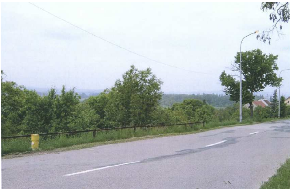
Obr. 8 Fotografie poruch komunikace
