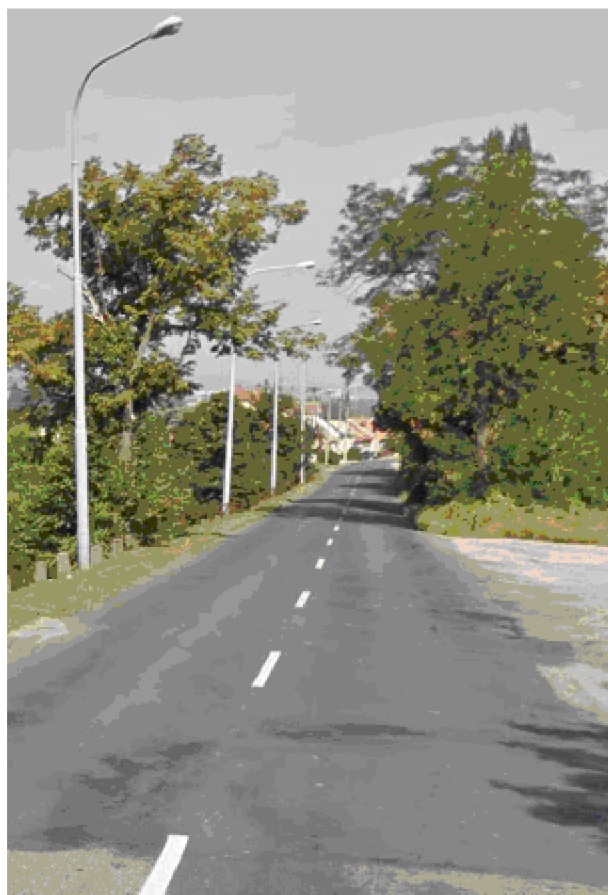
Obr. 10 Komunikace před opravou
