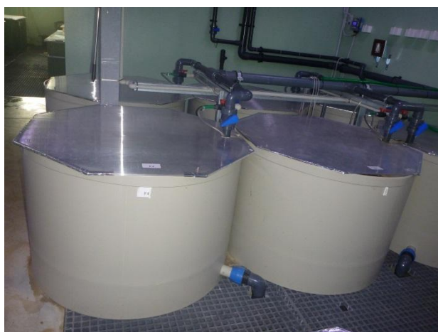
Obr. č. 17. Vnitřní plastové kruhové nádrže určené k odchovu raných i odkrmených stádií ryb (foto M. Kahanec).
