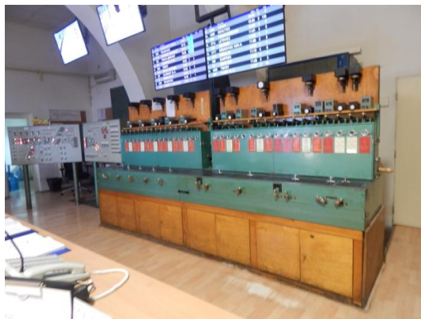
Obrázek 9: Elektromechanický řídicí přístroj v žst. Brno hl.n.
