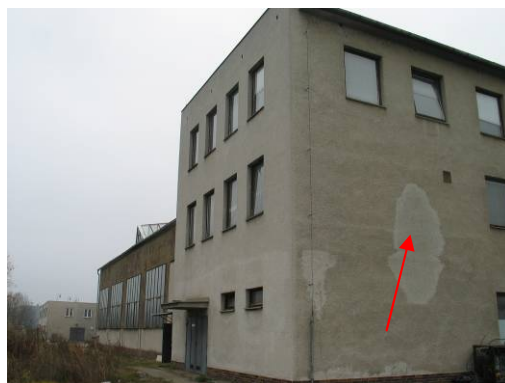
Obr. 20: Příklady projevu prasklého vodovodu na fasádě objektu (Brada 2015)
