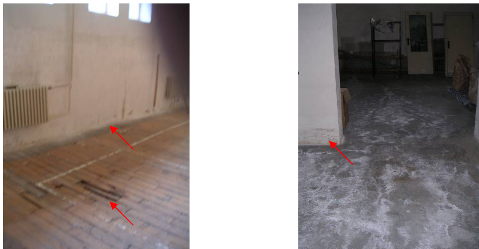
Obr 35, 36: Špatně provedené hydroizolace způsobují vlhkost stěn, promáčení zánovní palubovky, popř. betonové podlahy, plísně se již začínají tvořit (Brada 2015)
