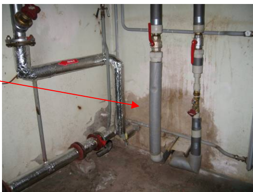
Obr. 19: Pronikání vlhkosti vadným prostupem (Brada 2015)
