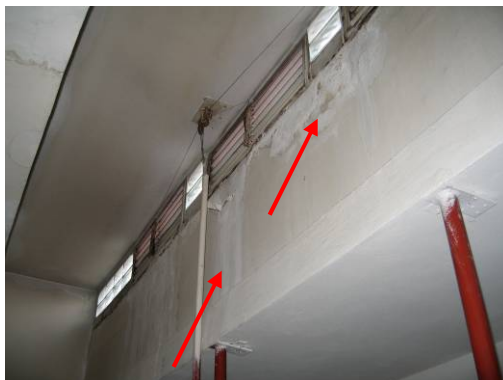
Obr. 18: Příklad zatékání srážkové vody větracími otvory v panelovém domu (Brada 2015)
