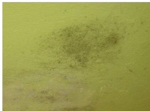
Obr. 22: Příklad nedostatečného větrání u stěny za nábytkem (Brada 2016)
