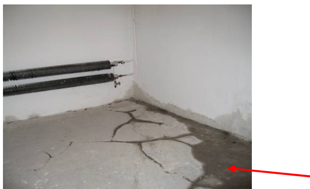
Obr.17: Příklad pronikání spodní vody vadnou hydroizolací ve vytápěném suterénu (Brada 2015)
