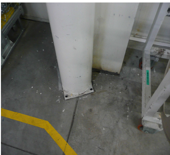
Obrázek 2.14 - Neprovedení kotvení v patě sloupu JD.
