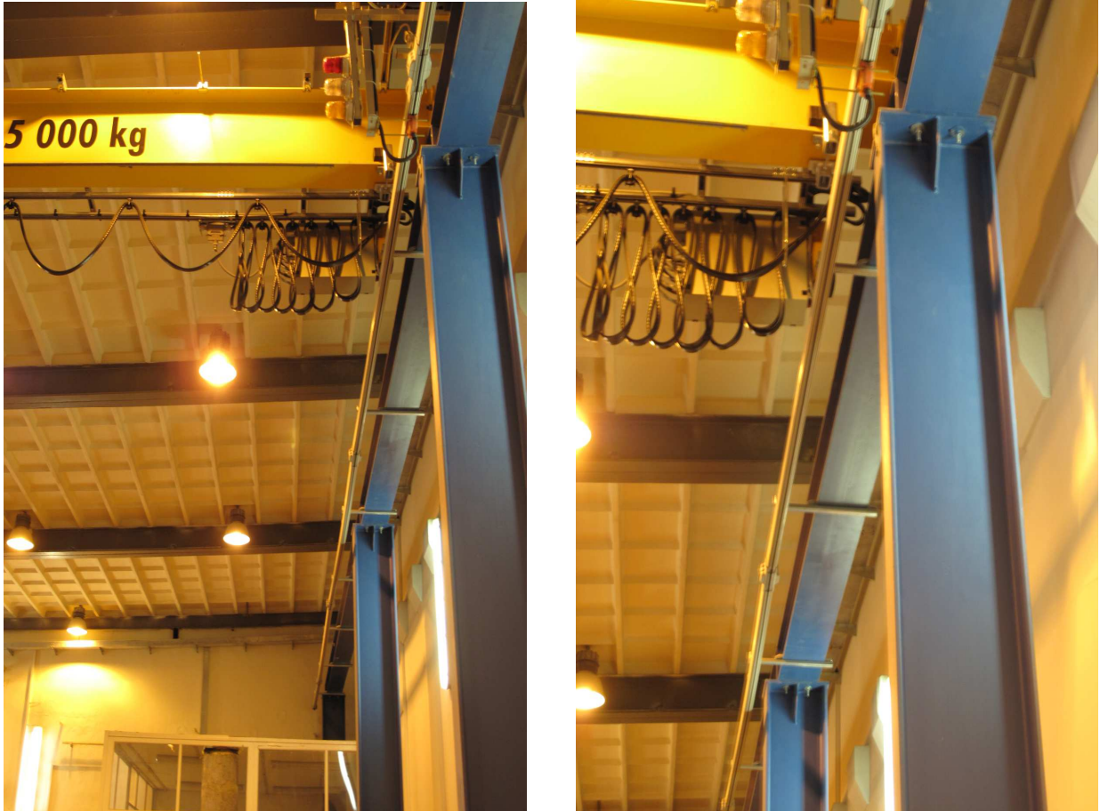
Obrázek 10.9 – Jeřábová dráha pro jeřáb Demag o nosnosti 5000 kg, laboratoř Ústavu kovových a dřevěných konstrukcí, FAST, VUT v Brně.
