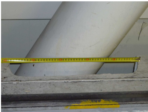
Obrázek 2.16 - Vypálený úhelník hlavního průřezu nosníku jeřábové dráhy uprostřed pole.
