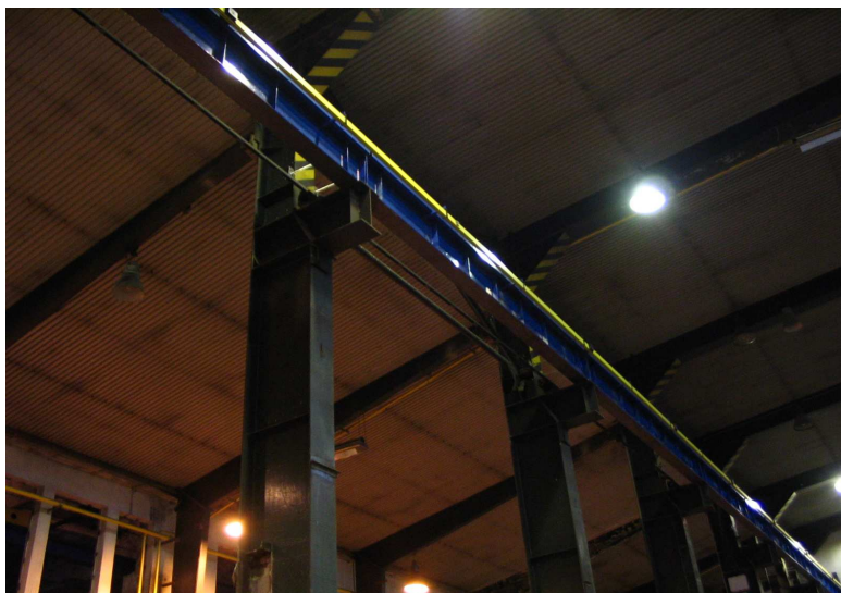
Obrázek 2.18 - Demontovány prvky podélného ztužidla haly a jeřábové dráhy a pruty zajišťující vzpěrné délky hlavních sloupů haly.
