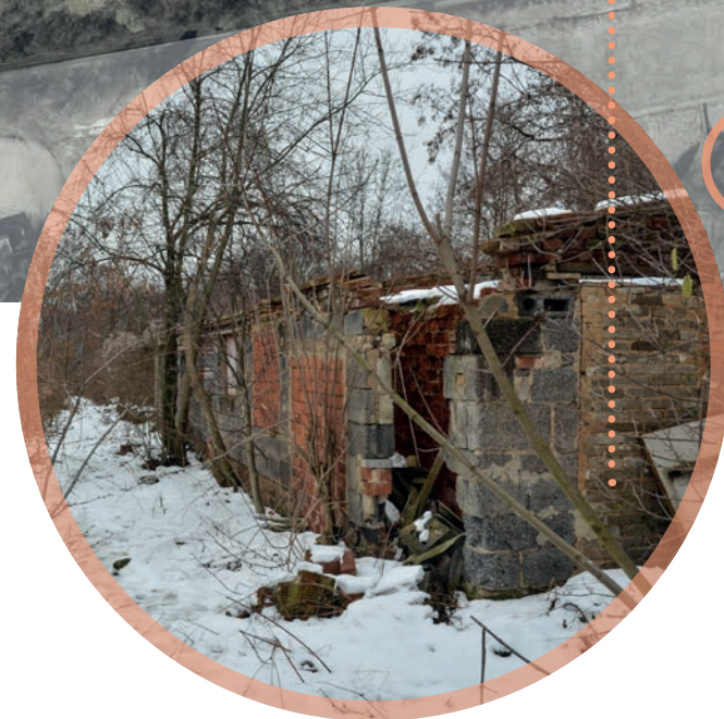
obr. 100: Ruina budovy prorůstající pionýrskou vegetací (Cimburová 2019)
