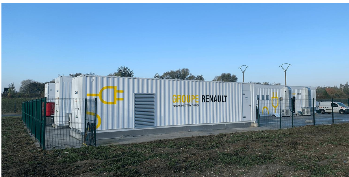
Obrázek 43 Projekt Advanced Battery Storage [94]
