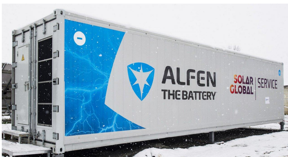
Obrázek 39 Bateriové úložiště Solar Global [90]
