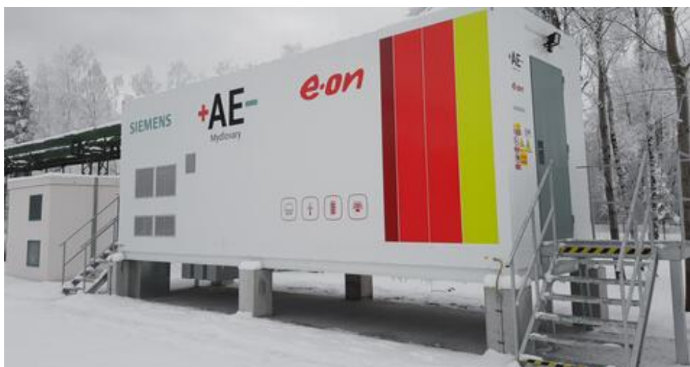
Obrázek 38 Bateriové úložiště E.ON [88]
