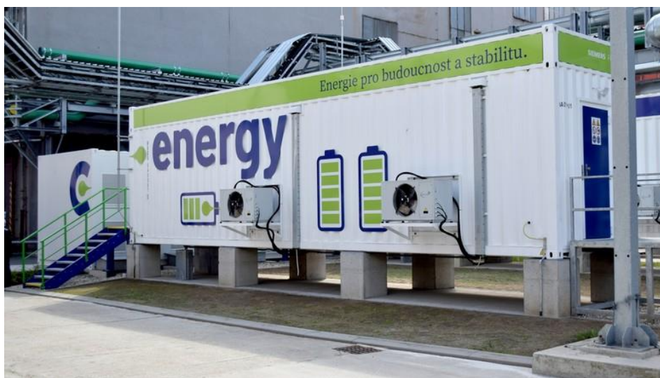
Obrázek 40 Bateriové úložiště C-Energy Planá [91]
