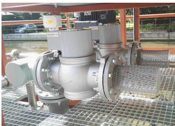
Obr. 6.8 Instalované dvoucestné ventily EVPE 1100/NO na lokalitě MVE Želina
