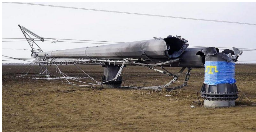
Obrázek 7 – Poškozené elektrické vedení – Krym
