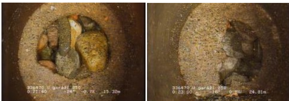
Obrázek 14: Poškozená víčka rezervních odboček v úseku číslo 3 (Pražské vodárny a kanalizace a.s., 2018).
