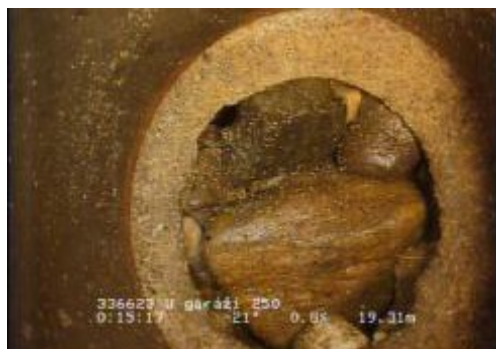
Obrázek 12: Poškozené víčko rezervní odbočky v úseku číslo 2 (Pražské vodárny a kanalizace a.s., 2018).
