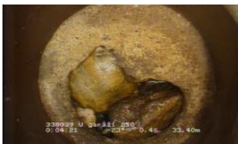
Obrázek 11: Poškozené víčko rezervní odbočky v úseku číslo 1 (Pražské vodárny a kanalizace a.s., 2018).
