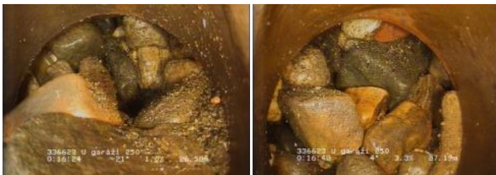
Obrázek 13: Chybějící víčka rezervních odboček na úseku číslo 2 (Pražské vodárny a kanalizace a.s., 2018).
