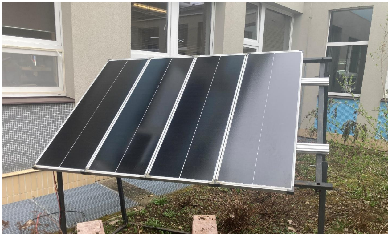
Obrázek 14 - Instalované fotovoltaické panely
