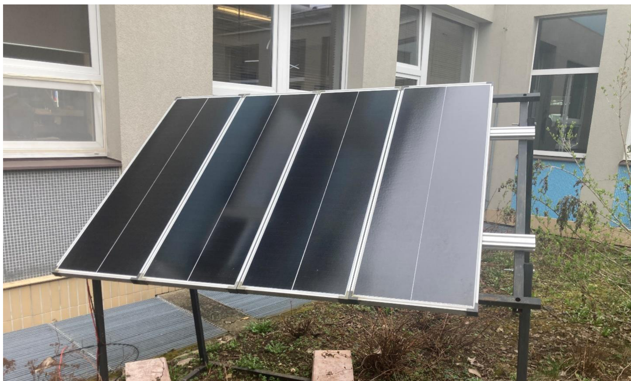
Obrázek 14 - Instalované fotovoltaické panely
