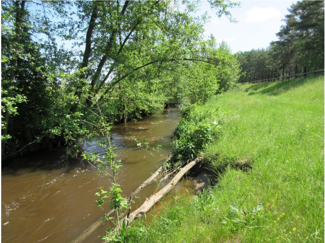
Příloha č.5 – Erodivání břehu (foto: V. Podlaha)
