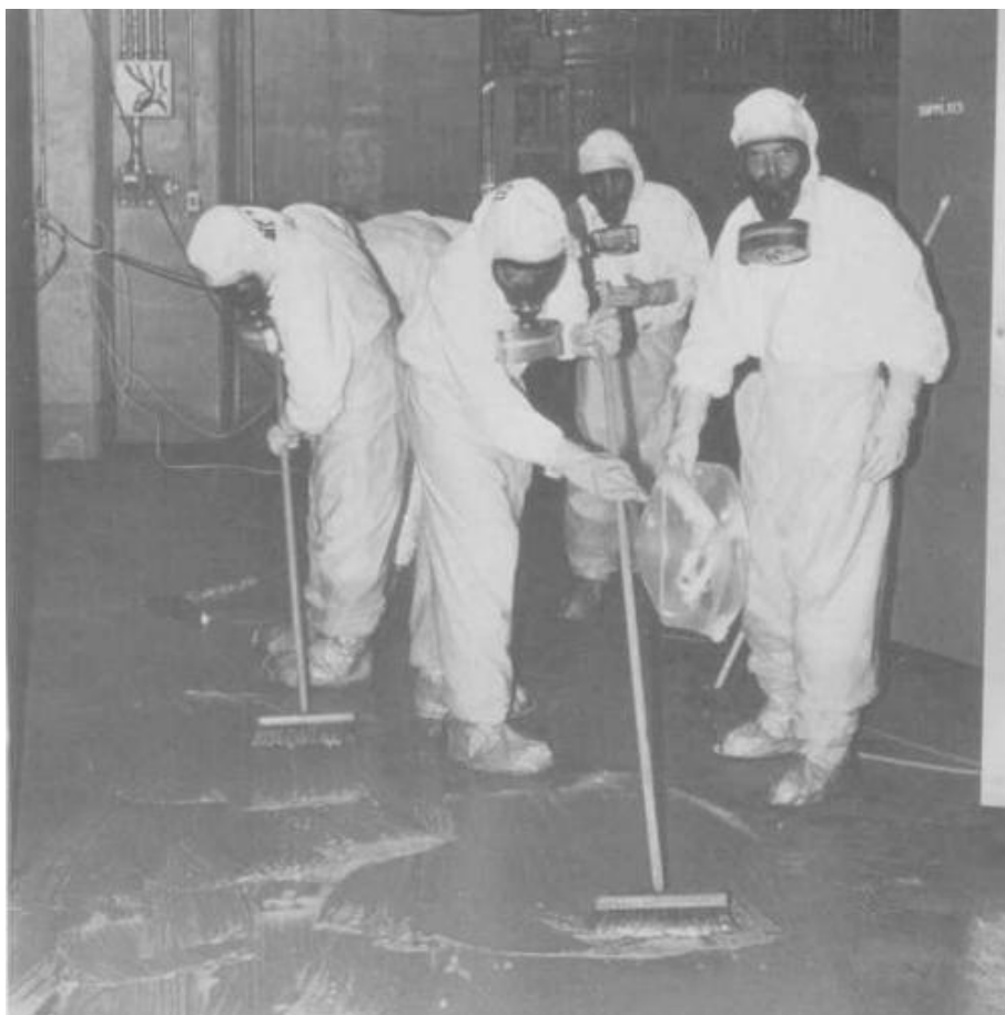
Obrázek č.4 Dekontaminace havarované elektrárny TMI-2 – převzato z [12]
