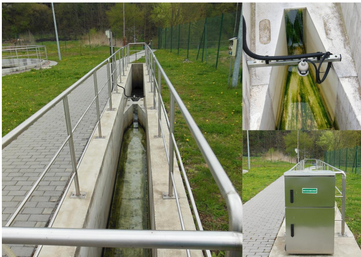
Fotografie č. 9 – Parshallův žlab (archiv autora)
