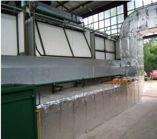
Obr. 15 Rozvodové potrubí horkého vzduchu pod jednotlivé komory
