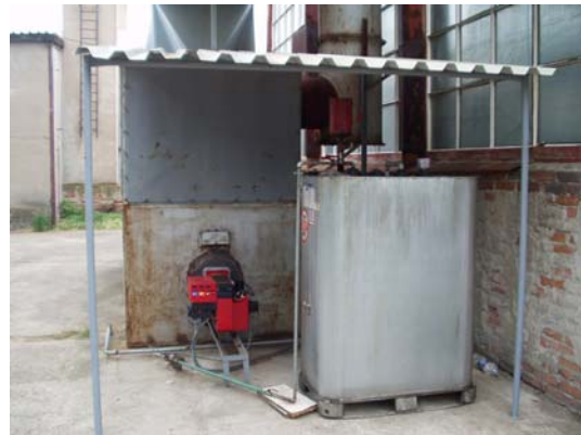
Obr. 12 Hořák, výměník tepla a nádrž na LTO
