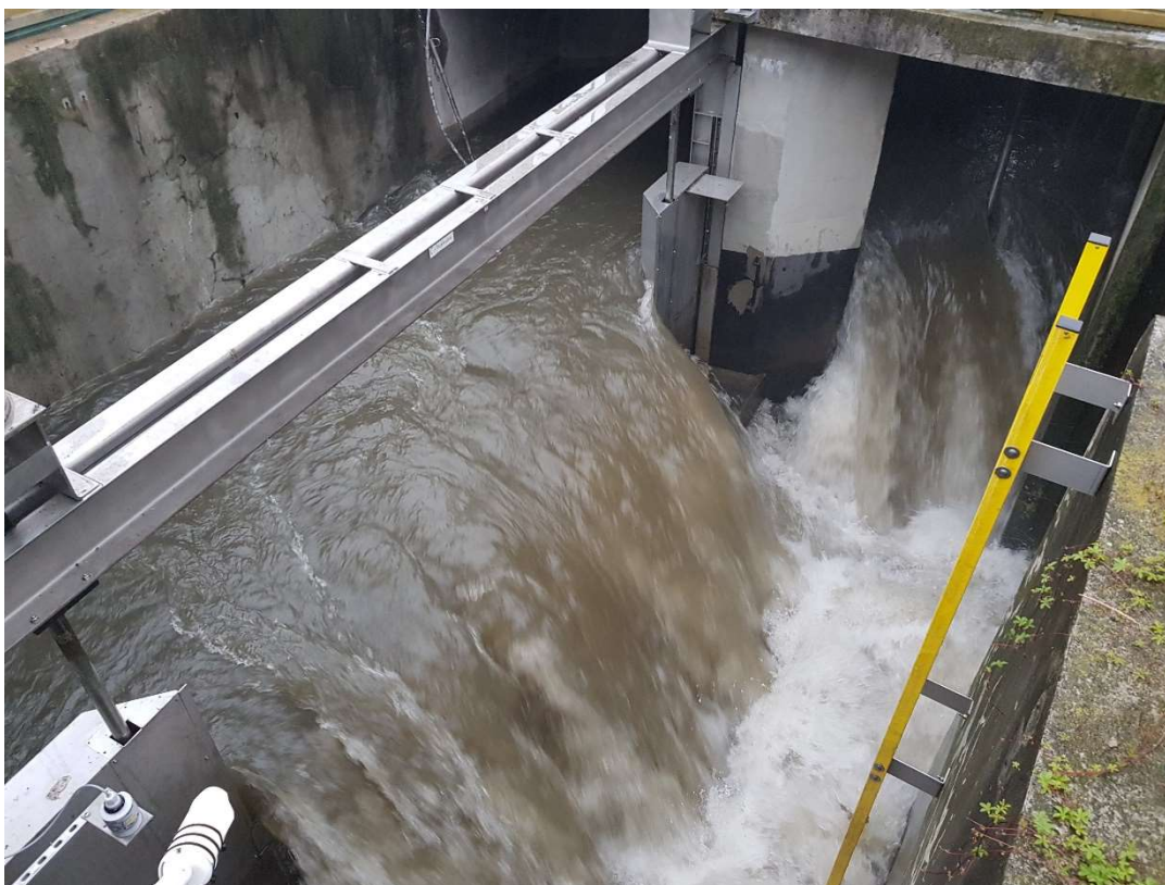
Obr. 35) Přepad vody přes pohyblivý tabulový uzávěr a pevné stavidlo
