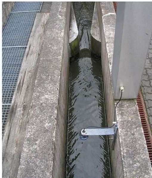
Obr. 12) Ultrazvukový snímač firmy Nivus instalovaný před měrným žlabem typu Venturi [13]
