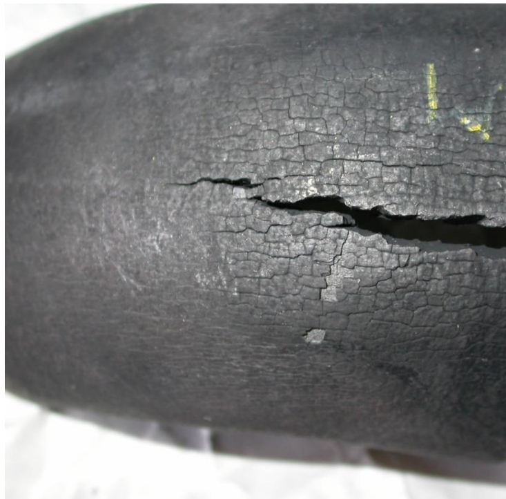
Obrázek 22 – Popraskaný povrch potrubí s tepelnou prasklinou odprýskanými oxidy
