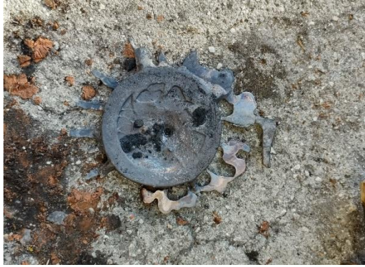
Obr: 92: chybný odlitek, nedostatečné zalití do detailů
