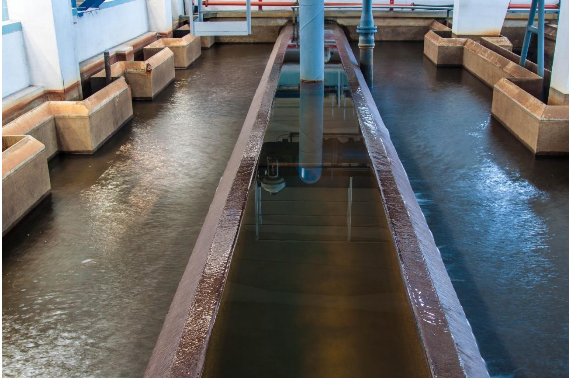
Obrázek č. 8 – Pískový rychlofiltr na Staré filtraci v ÚV Podolí, zdroj: autor
