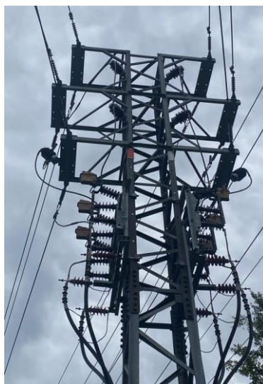
Obrázek 7.2 – Aktuálně umístěný příhradový stožár linky Kaplice a Přídolí [vlastní zpracování]
