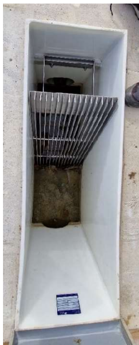
Obrázek 10: Novější provedení ručně stíraných česlí v obci Hlína
