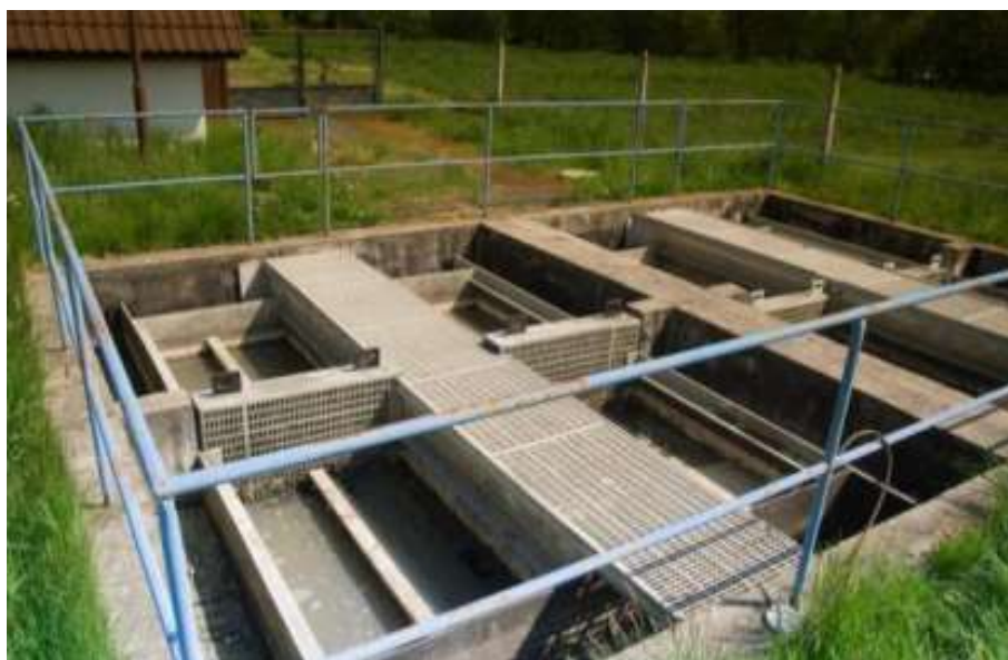
Obrázek 12: Odkrytá štěrbinová usazovací nádrž s bezpečnostním filtrem [2]
