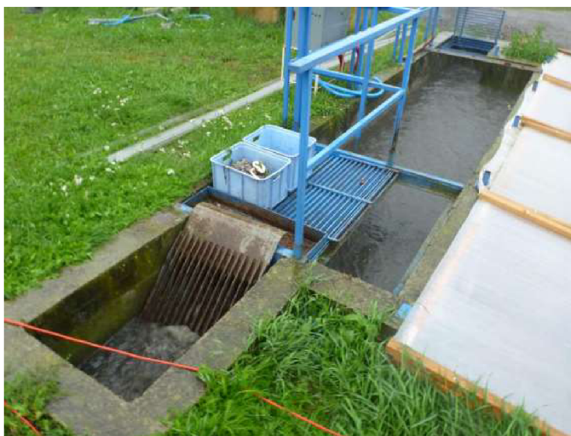
Obrázek 9: Starší realizace ručně stíraných česlí tvořící sdružený objekt s lapákem písku v obci Dražovice
