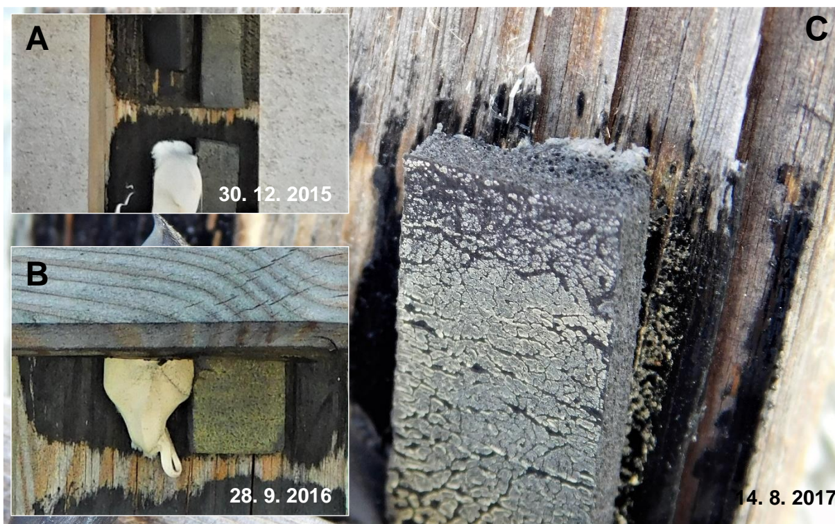
Obrázek č. 92 – Degradace exponované montážní pásky: a) po 6 měsících je páska mírně degradovaná; b) po roce již dochází k mírnému odlepování pásky; c) kompletní odlepení pásky;
