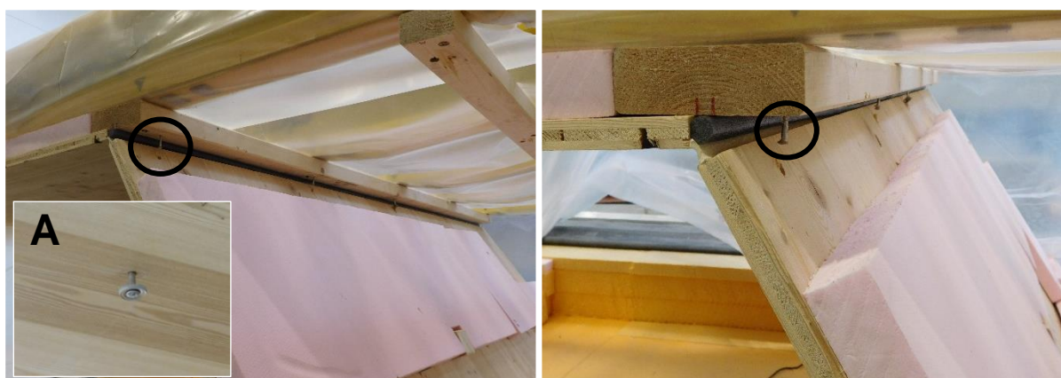
Obrázek č. 91 – Porušení segmentu s mechanickým spojem a obkladem ze sibiřského modřínu: a) povytažení kotevního prvku
